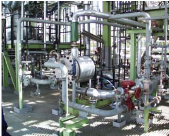
■エバポレータ 4350kW (製薬プラント)
