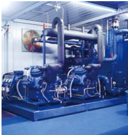
■エバポレータ 480kW (アンモニア/エチレングリコール25%)
